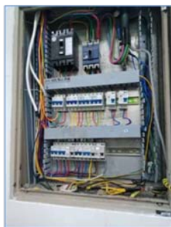
生物楼B09房间配电箱 线路杂乱（整改前）
