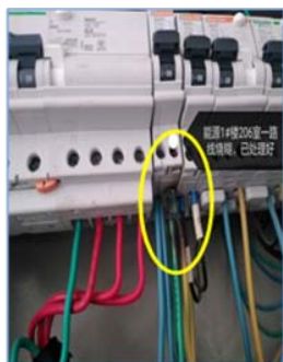
能源1号楼206房间配电箱 一路线烧糊（整改前）
