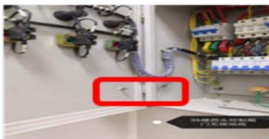
36#楼西侧控制箱门无接地线
