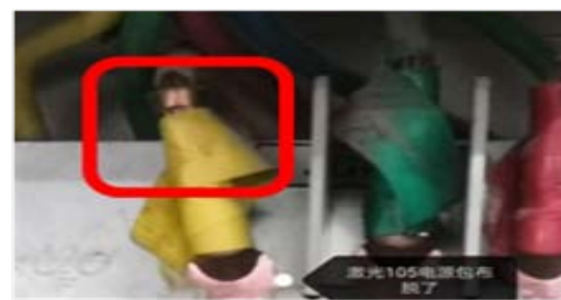
29#楼105房间电源线包布脱落
