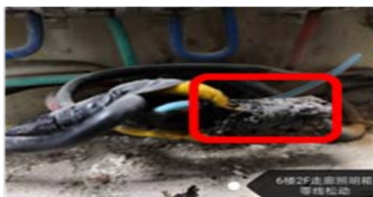
6#楼走廊照明箱零线松动
