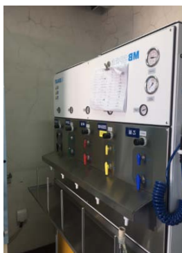
有机溶剂 净化系统
